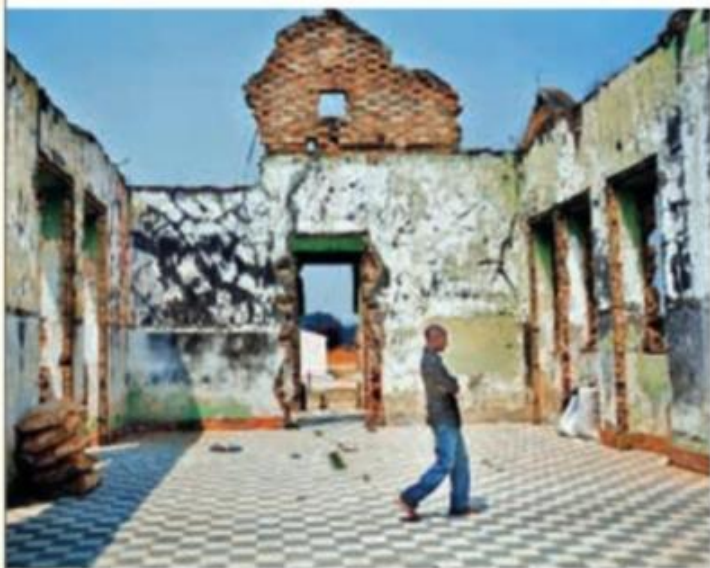
Edifício destruído na província de Huambo durante a guerra civil em Angola. Foto de 2008.
